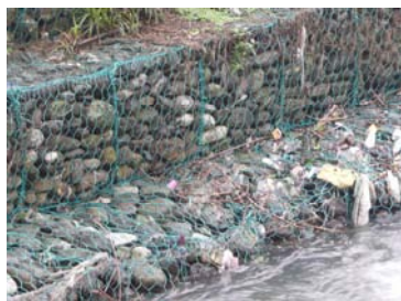
圖 147：河岸生態工法蛇籠有鬆動情形可以考慮用環保的建材鞏固不致被水沖垮
